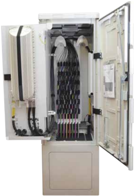
TSO-Netze KVz UNI 4 FTTX Verteiler
