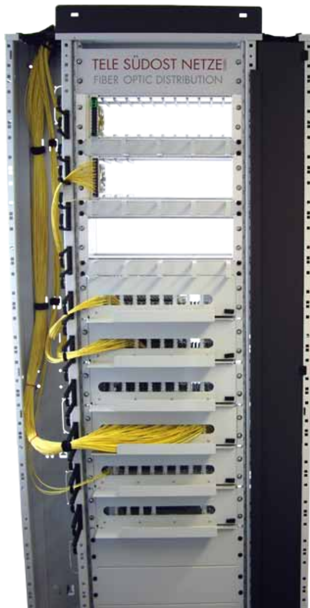
TSO-Netze OIF Rack mit Spleiss- und Splittermodulen
