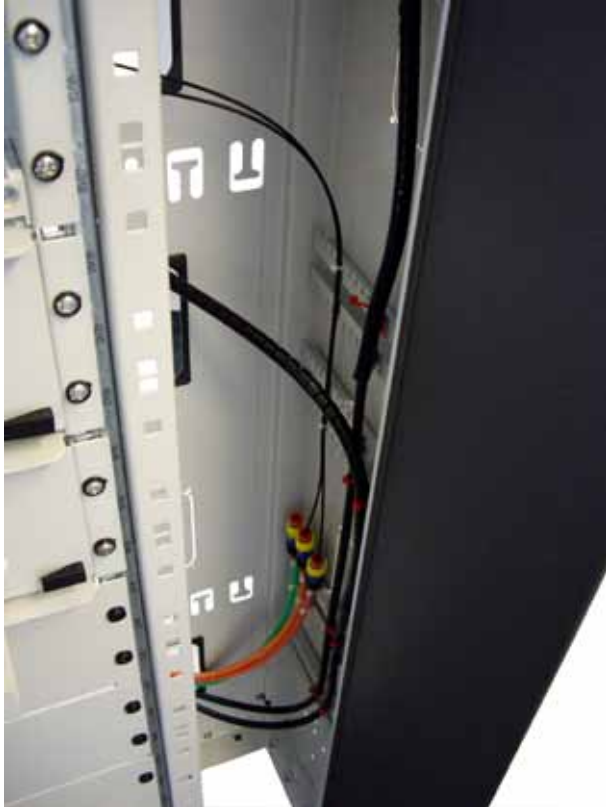
OIF Gestell - Kabelführungskanal rechte Seite
